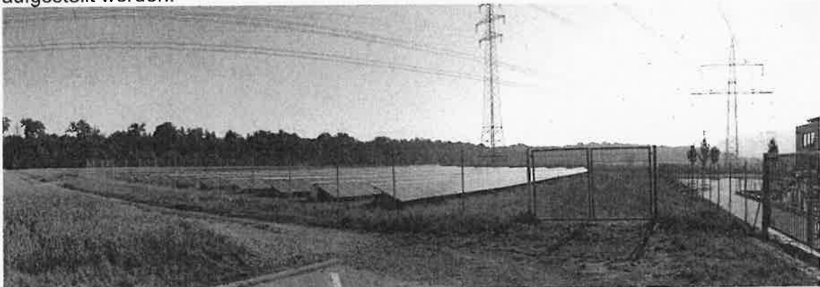
Abb.: bestehende Freiflächenphotovoltaik-Anlage
